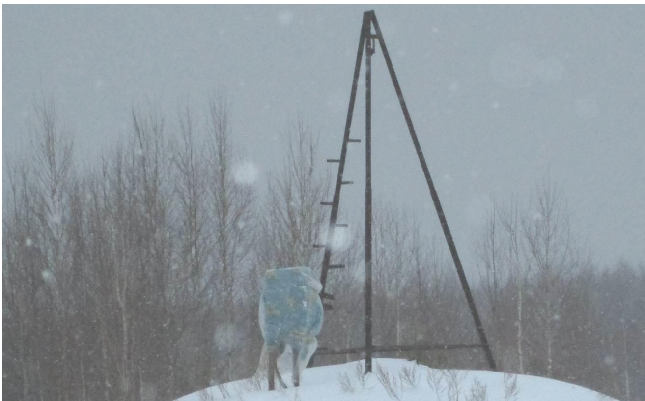
Рис. 1.65. Металлический бокс скважины №10 ул. Полевая, 5а п.Алтышево
