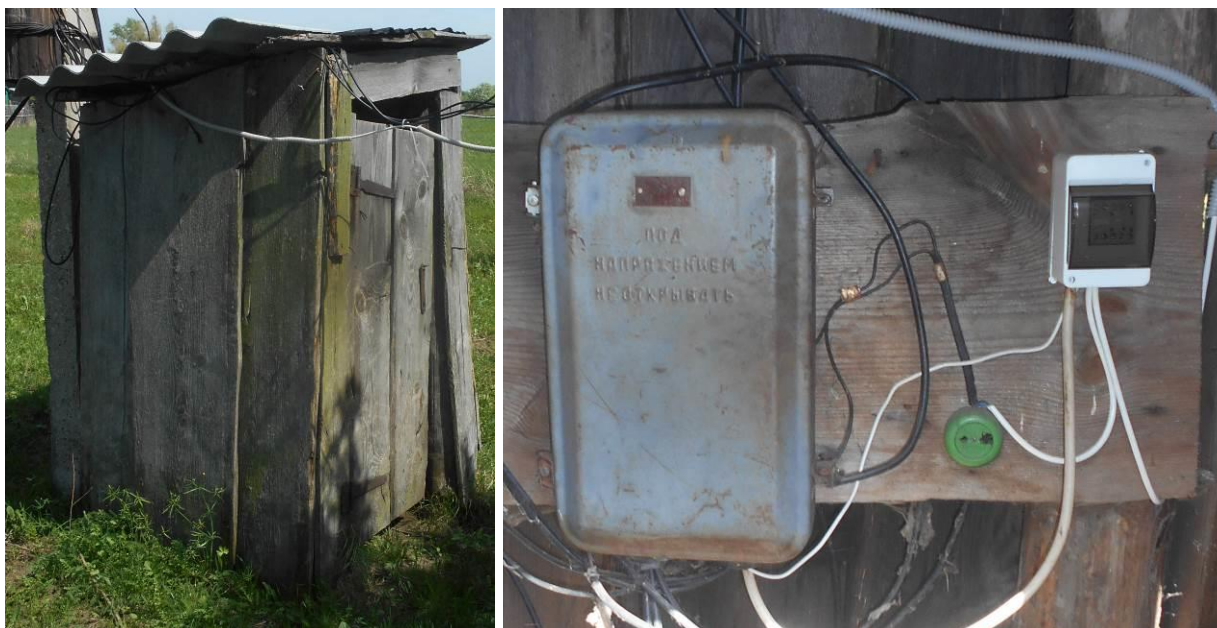
Рис. 1.35. Павильон с электрическим щитом скважины п.Анютино
