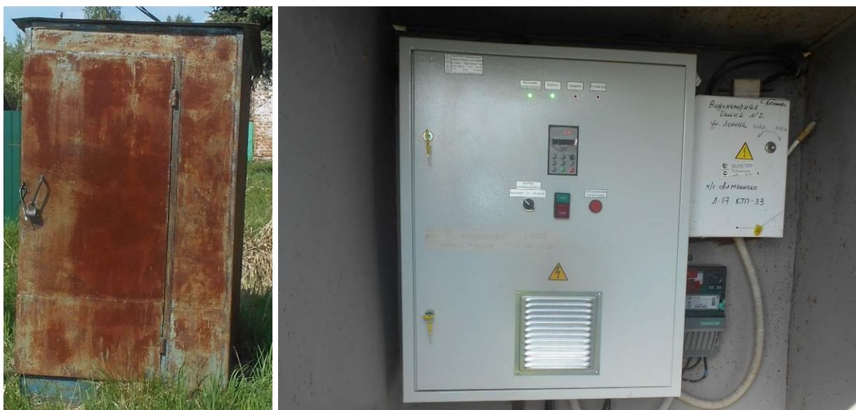
Рис. 1.31. Павильон с электрическим щитом скважины по ул.Ленина
