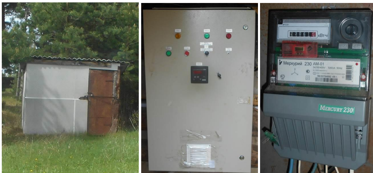
Рис. 1.67. Павильон с электрическим щитом скважины с.Чуварлеи
