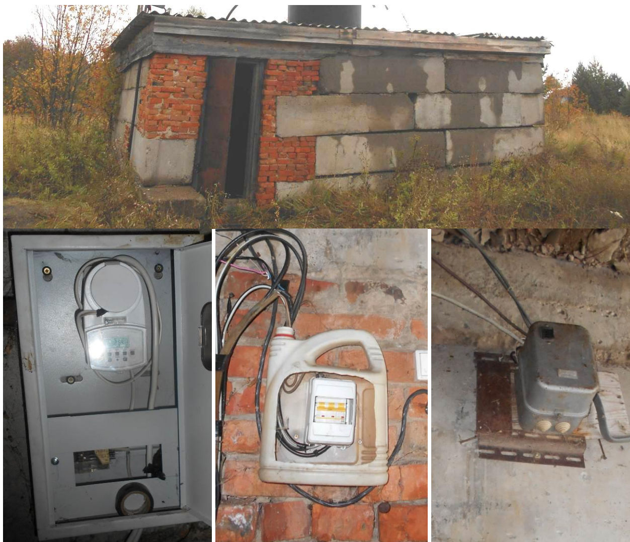
Рис. 1.56. Павильон и электрооборудование скважины с.Явлеи
