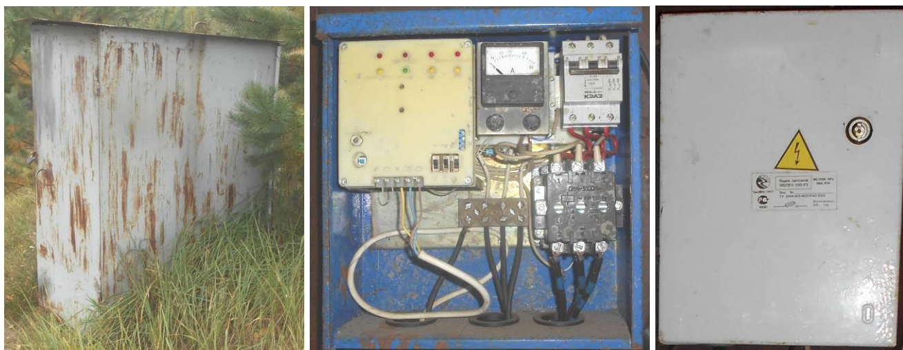
Рис. 1.38. Павильон и электрические щиты скважины ФСК с.Атрать
