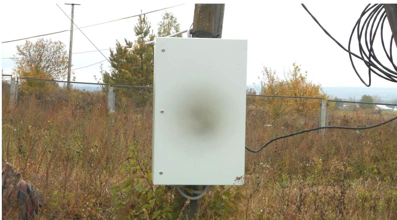
Рис. 1.53. Металлической бокс скважины по ул.Комиссариатская с.Миренки
