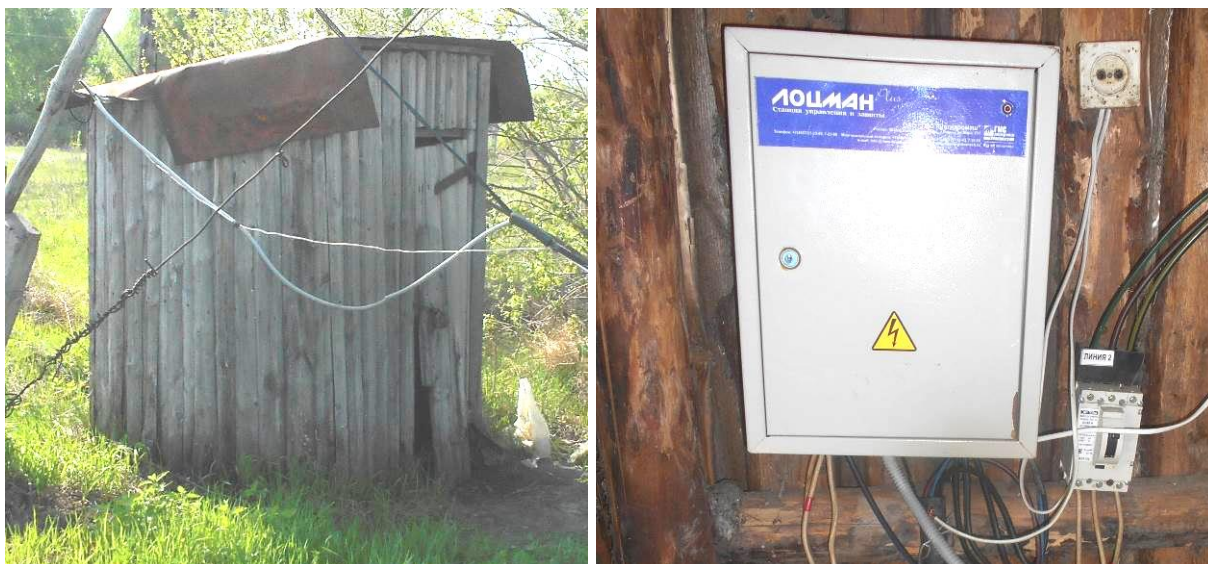
Рис. 1.51. Павильон с электрическим щитом скважины с.Кувакино
