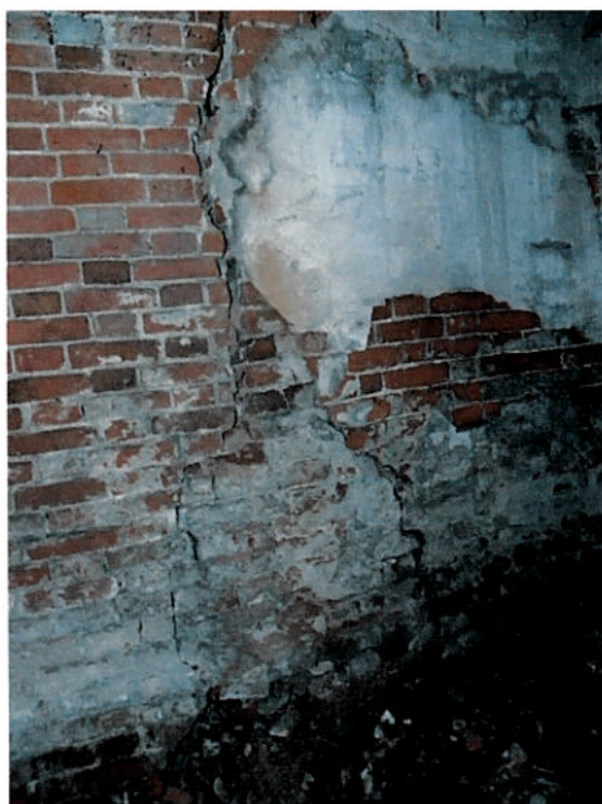
Фото № 22. Трещина на стене.
