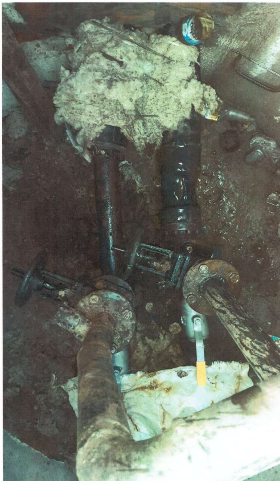
В тепловой камере ТК-3 стальной трубопровод без тепловой изоляции
