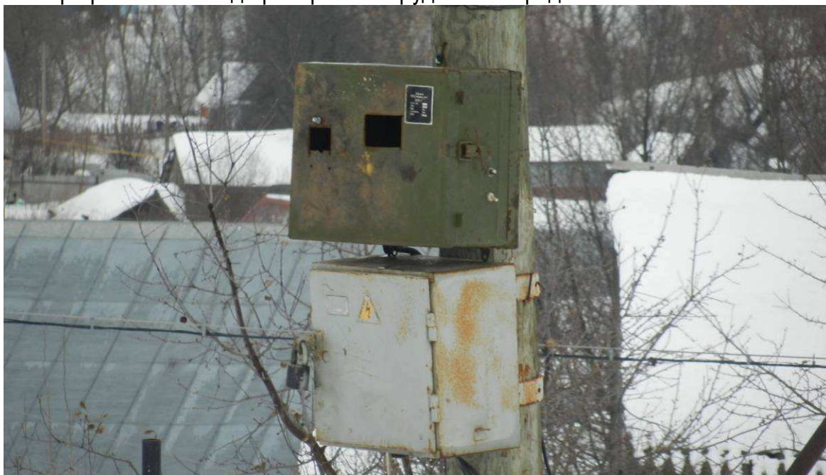
Рис. 1.19. Боксы под приборы и оборудование артезианской скважины №6 с. Ишлеи
