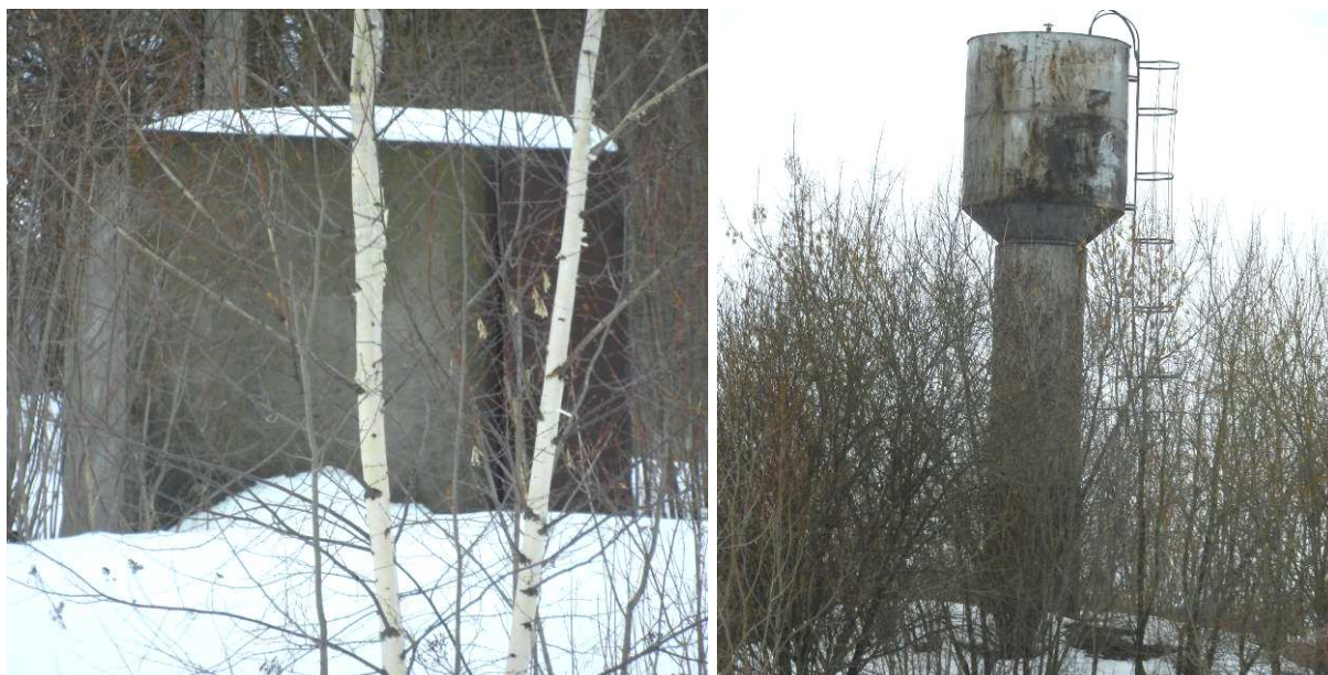
Рис. 1.28. Павильон и водонапорная башня от артезианской скважины д. Хачики
