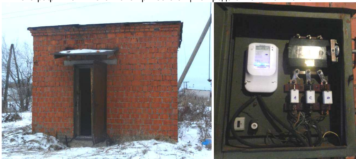
Рис. 1.8. Павильон с электрическим щитом артезианских скважин №1 и №2 д. Б.Катраси
