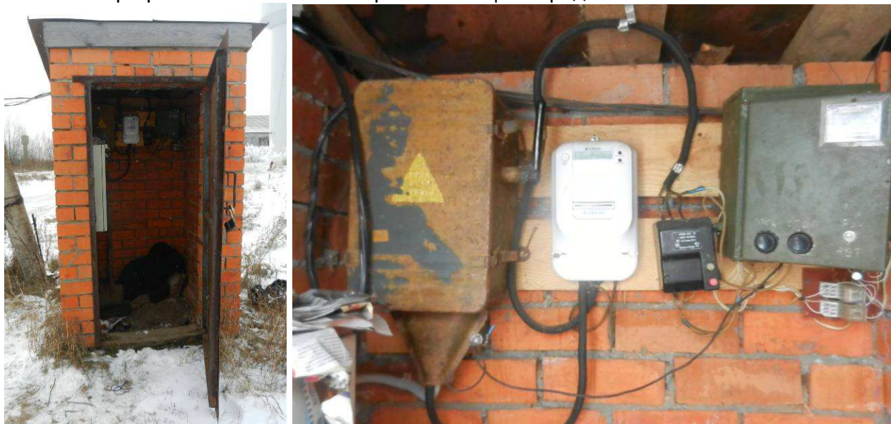
Рис. 1.11. Павильон с электрическим щитом артезианской скважины №3 д. Митрофанкасы
