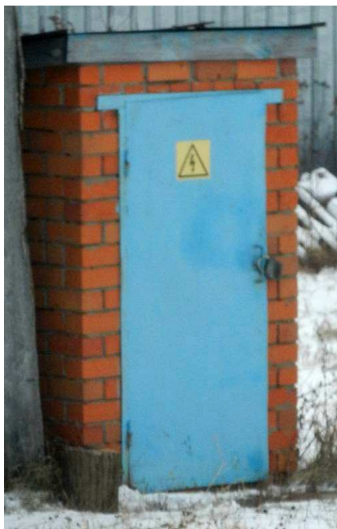
Рис. 1.13. Павильон с электрическим щитом артезианской скважины №4 д. М. Янгильдино
