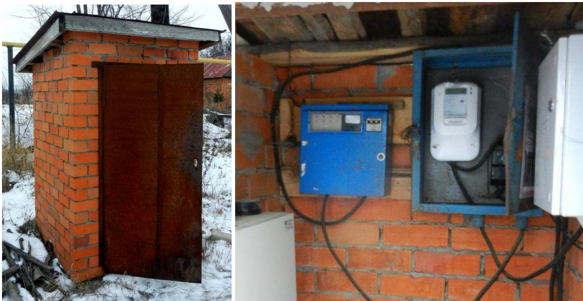
Рис. 1.19. Павильон с электрическим щитом и приборами учета электроэнергии артезианской скважины №7 д. Сархорн
