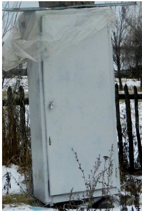
Рис. 1.15. Павильон с электрическим щитом и приборами учета электроэнергии артезианской скважины №5 д. Малые Карачуры
