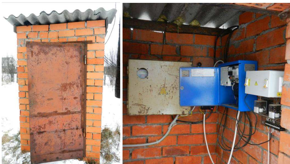
Рис. 1.17. Павильон с электрическим щитом и приборами учета электроэнергии артезианской скважины №6д. Василькасы
