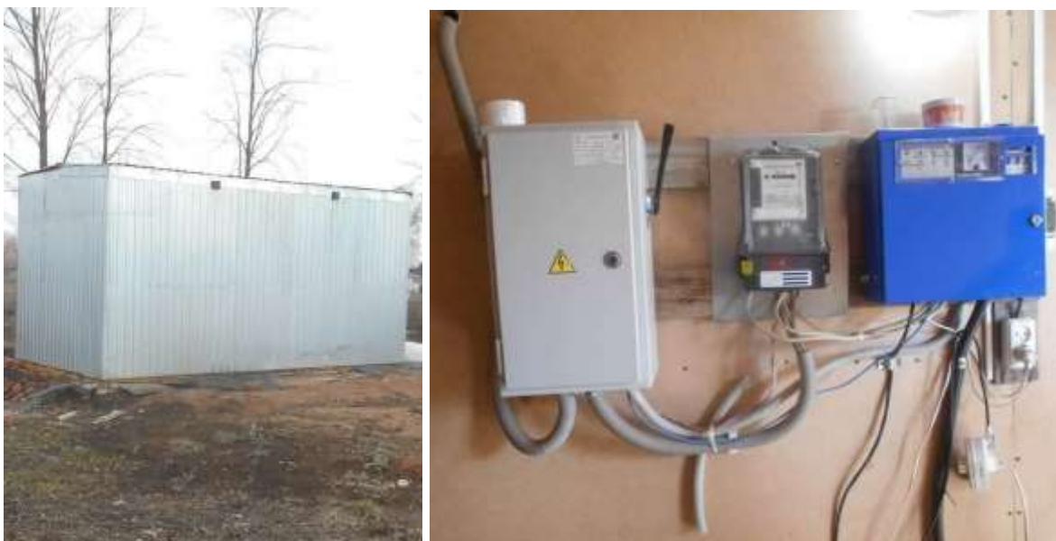
Рис. 1.22. Павильон, электросчётчик и щита с автоматической системой управления погружным насосом артезианской скважины по д. Подлесное
