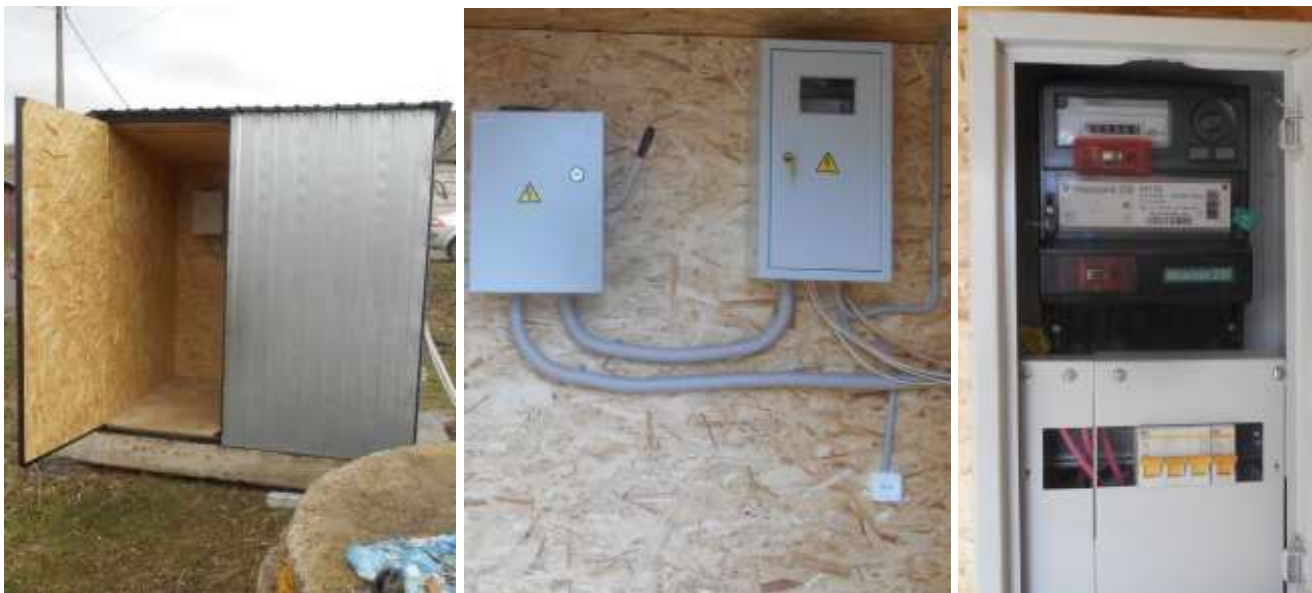
Рис. 1.12. Павильон, электросчётчик и щит управления насосом артезианской скважины
