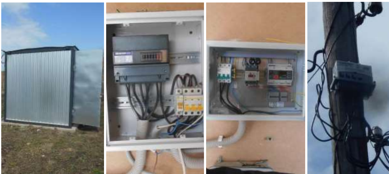
Рис. 1.18. Павильон, электросчётчик и щита с автоматической системой управления погружным насосом артезианской скважины по с. Русские Норваши
