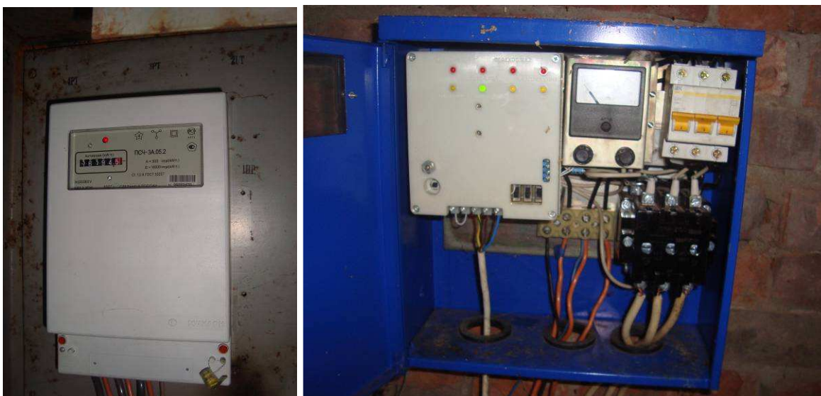
Рис. 1.16. Павильон с электрическим щитом артезианской скважины №4 с. Абашево
