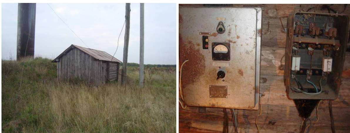
Рис. 1.22. Павильон с электрическим щитом и приборами учета электроэнергии артезианской скважины №1 д. Клычево
