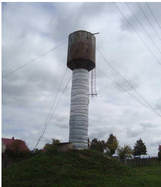
Рис. 1.21. Водонапорная башня от артезианской скважины д. Моштауши
