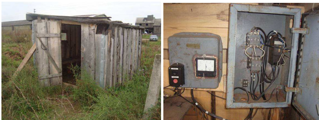
Рис. 1.24. Павильон с электрическим щитом и приборами учета электроэнергии артезианской скважины №2 д. Клычево
