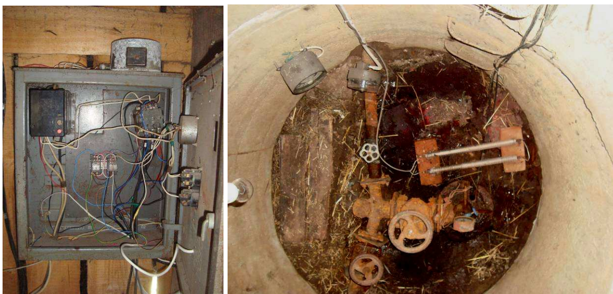
Рис. 1.26. Павильон с электрическим щитом и приборами учета электроэнергии артезианской скважины №1 д. Байсубаково
