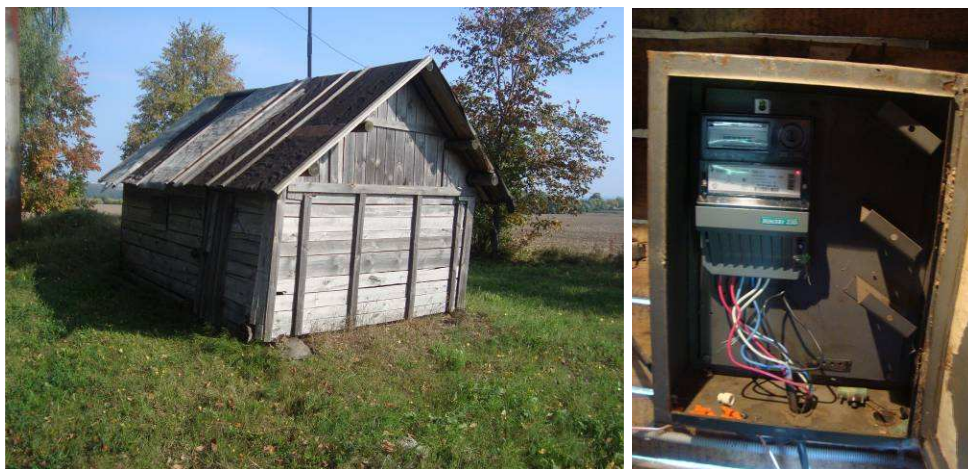
Рис. 1.28. Павильон с электрическим щитом и приборами учета электроэнергии артезианской скважины №2 д. Байсубаково
