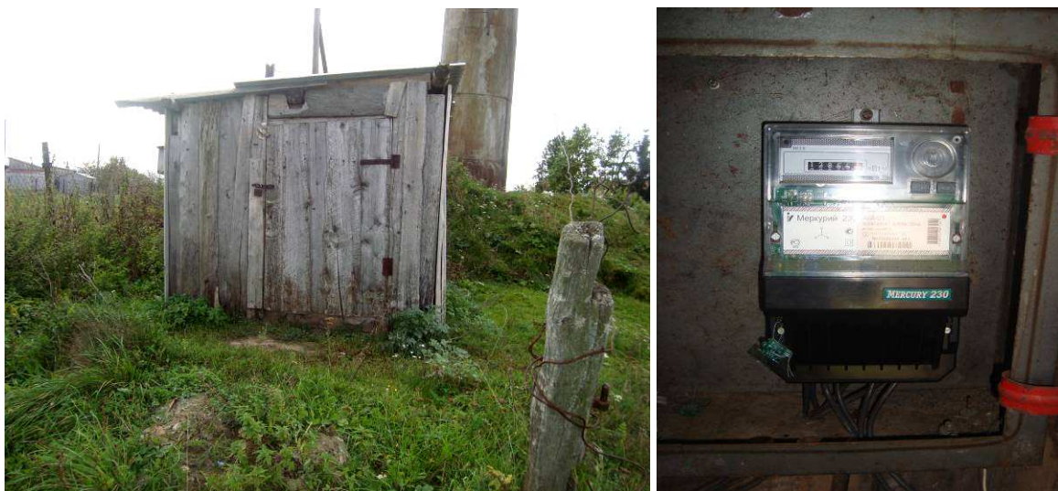
Рис. 1.18. Павильон с электрическим щитом и приборами учета электроэнергии артезианской скважины д. Завражное
