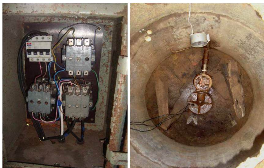
Рис. 1.14. Павильон с электрическим щитом артезианской скважины №3 с. Абашево
